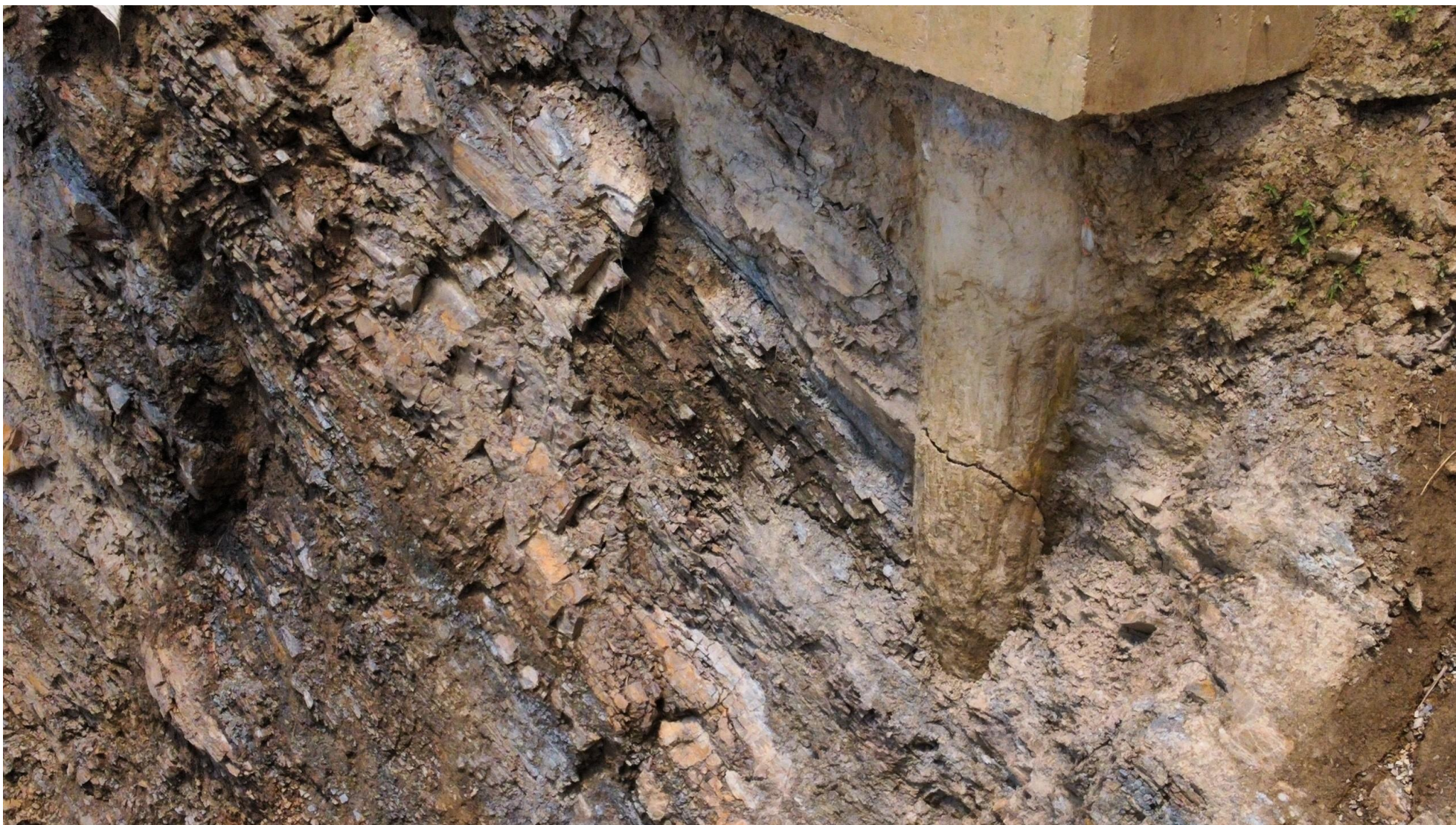
Hình ảnh vết nứt ngang cọc khoan nhồi dưới trụ T1
