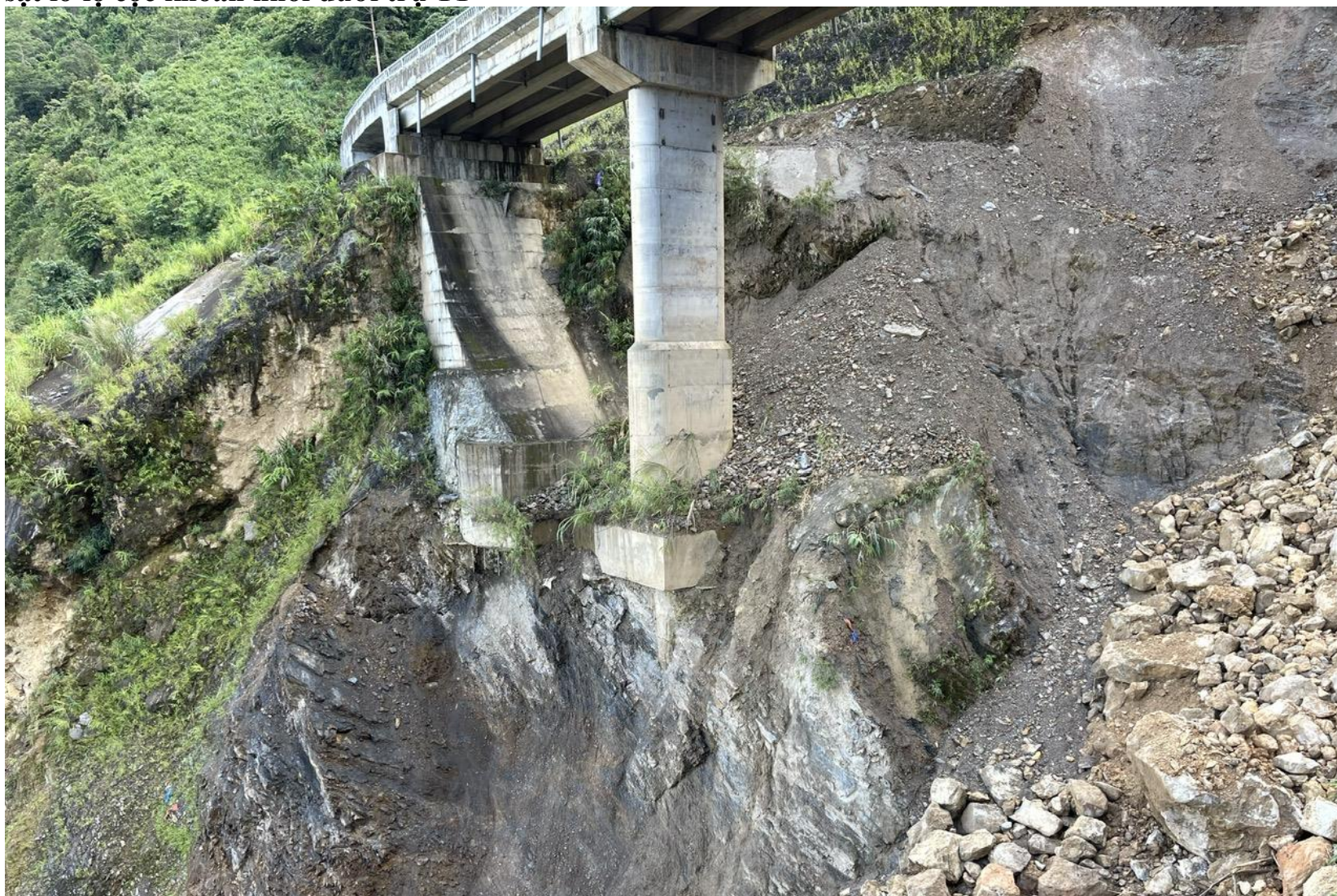
Hình ảnh sạt lở lộ cọc khoan nhồi dưới trụ T1
