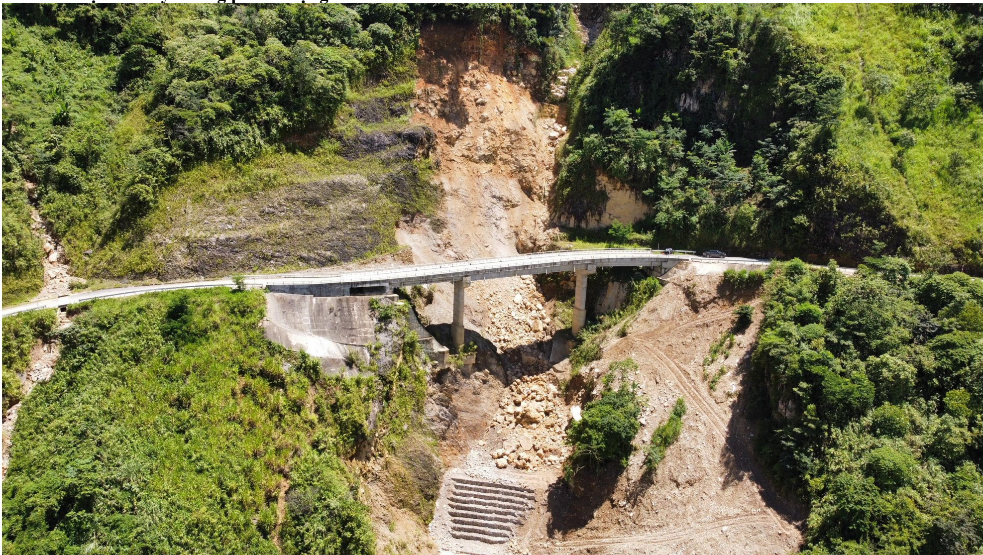
Hình ảnh sạt lở taluy dương phía thượng lưu cầu
